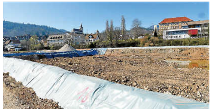
Der Überflutungsschutz grenzt den belasteten Bereich ab.
