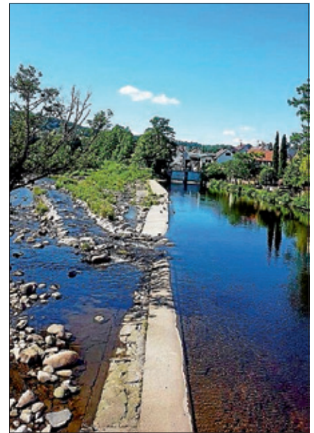
Die Abwasserleitung zwischen der Bleichstraße und dem Mühlgrabenweg wird instandgesetzt. Foto: Stadt Gernsbach
