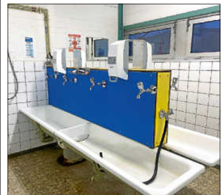
Die Sanitarräume müssen dringend saniert werden.
