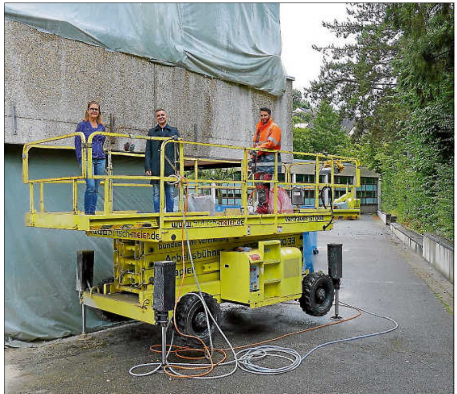
Bürgermeister Julian Christ und die städtische Architektin Elke Bräuer freuen sich über den Baustart. Fotos: Stadt Gernsbach
