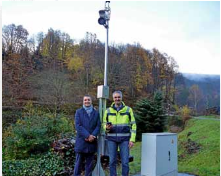
Bürgermeister Julian Christ und Bauhofleiter Simon Faber erklären die Funktionsweise der neuen Glätteisfrühwarnanlage.
