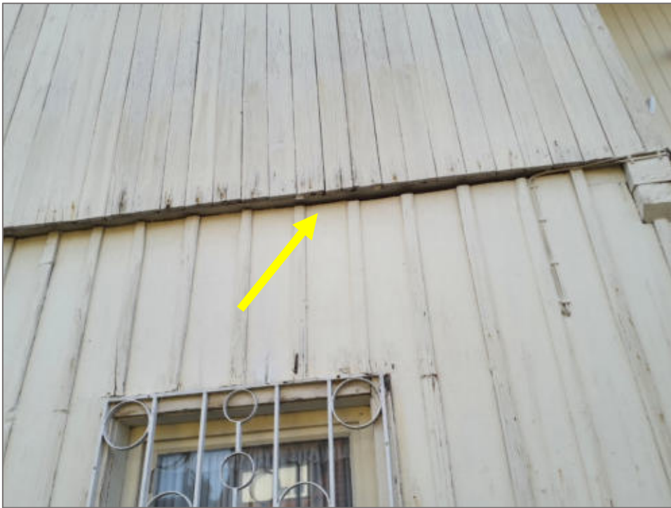
Abb. 16: Spalten in der westlichen Hauswand des Gebäudes der Uhlandstr. 16 (08.04.24)
