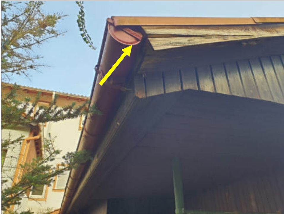
Abb. 14: Spalten im Dachtraufbereich am Südgiebel der Gartenhütte der Uhlandstr. 16 (08.04.24)
