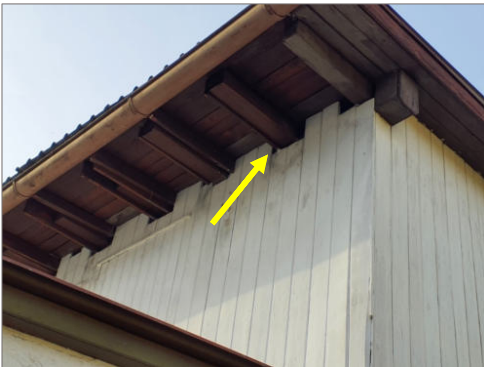
Abb. 15: Spalten zwischen Dachtrauf und Hauswand am Nordgiebel des Gebäudes der Uhlandstr. 16 (08.04.24)
