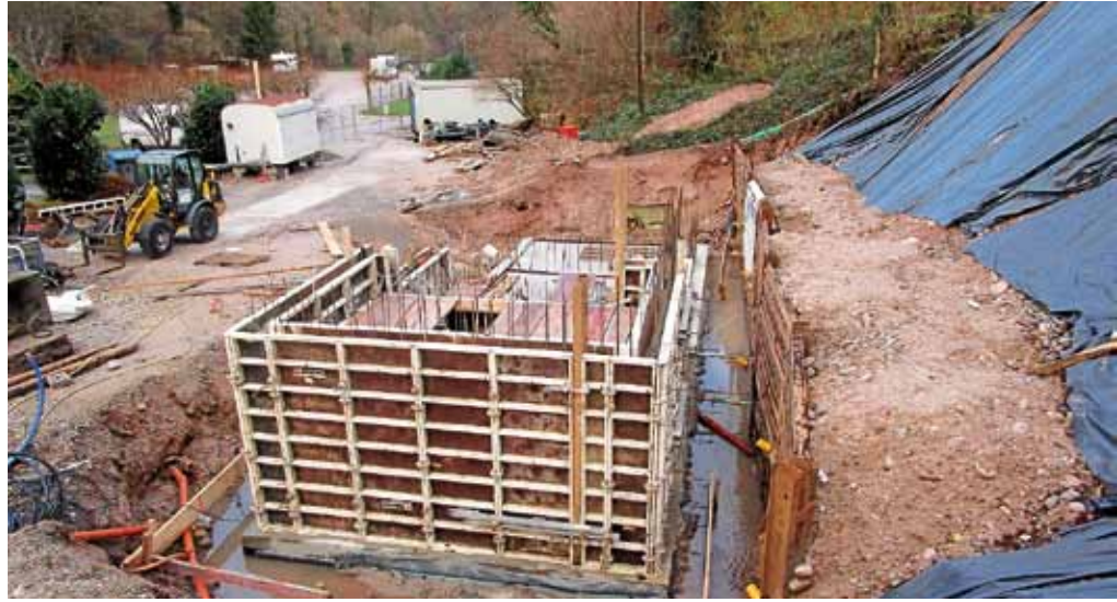
Das in Bau befindliche neue Filtergebäude für das Freibad Obertsrot. Foto: Stadt Gernsbach
