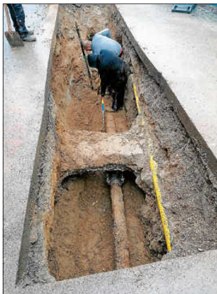
Reparierte Bruchstelle unter Betonabdeckung.
