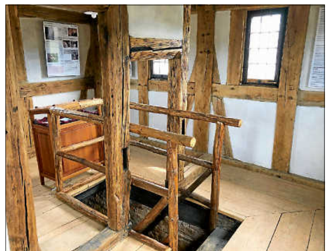
In der Turmstube des Storchenturmes ist mittelalterliche Fachwerktechnik zu bestaunen. Die Balken stammen aus dem Jahr 1470. Foto: Regina Meier
