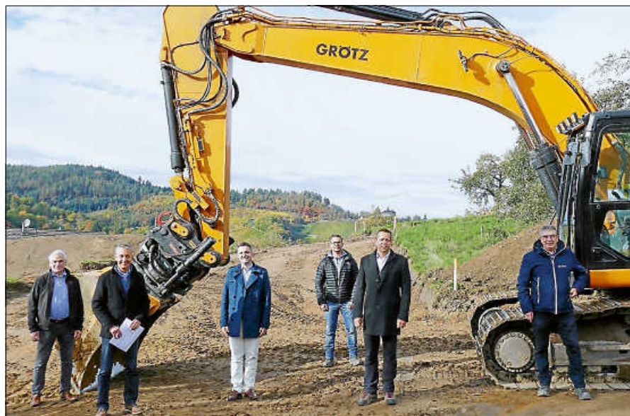
V. l. n. r.: Ortsvorsteher Walter Schmeiser, Stefan Ursprung, KBB GmbH, Bürgermeister Julian Christ, Stefan Huber, Ingenieurbüro Baumeister, Michael Auer, Bauunternehmung Grötz, und Thomas Licht, NetzeBW. Foto: Stadt Gernsbach
