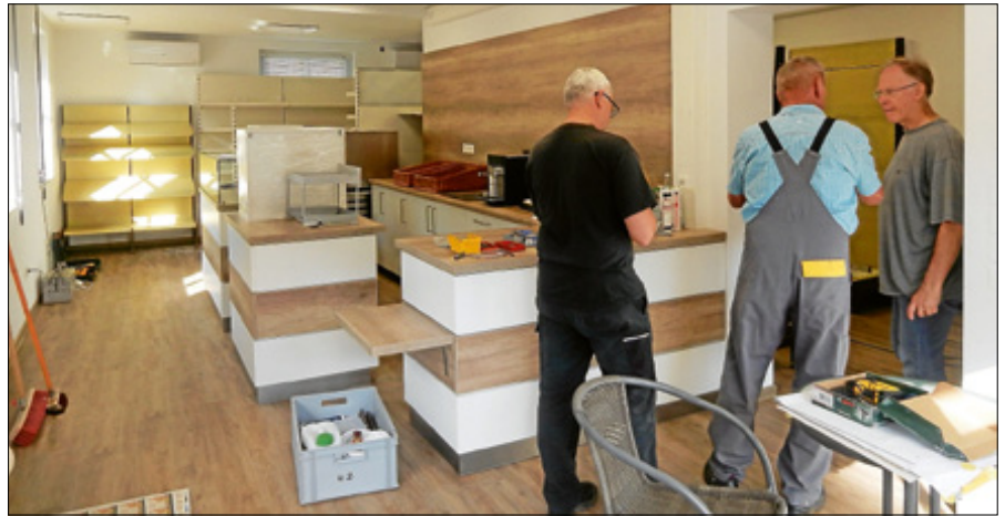
Im Moment wird noch kräftig gewerkelt im künftigen Dorfladen, damit zur Eröffnung alles fertig ist. Foto: Unser Dorfladen Reichental UG
